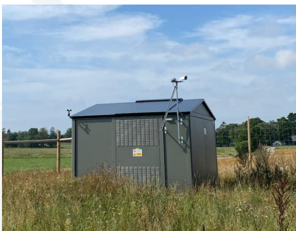
FIGUR 4. EXEMPEL PÅ HUR TRANSFORMATORSTATION KAN SE UT, DETTA EXEMPEL ÄR FRÅN SOLCELLSPARK I HALLAND
