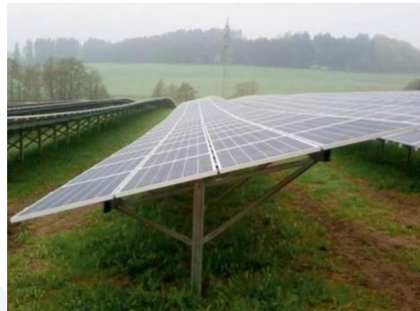
FIGUR 5. SOLPANELER PÅ STÅLPROFILER SOM PÅLATS NER I MARKEN
